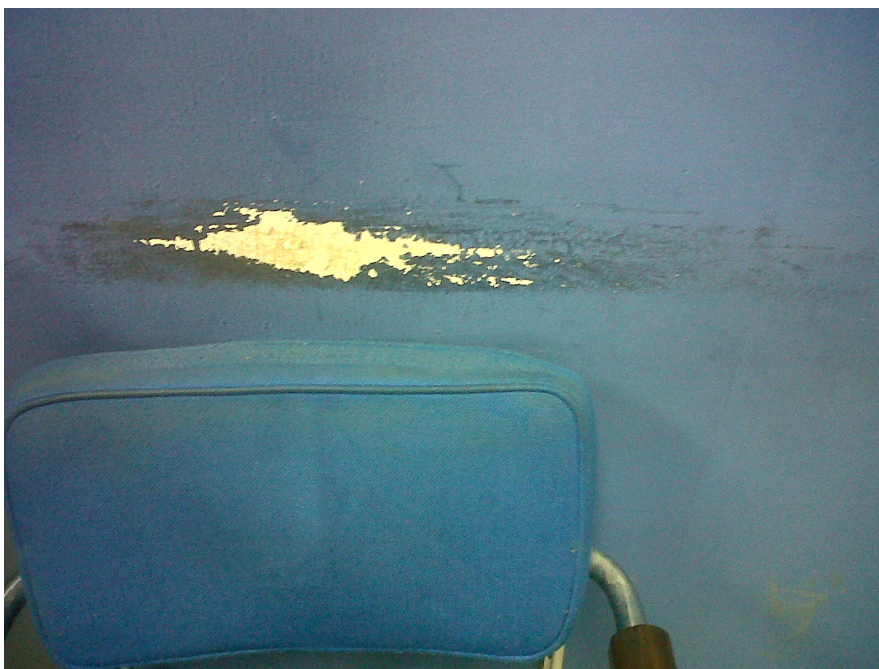
Figura 6. Condición de la pintura del área de recepción
