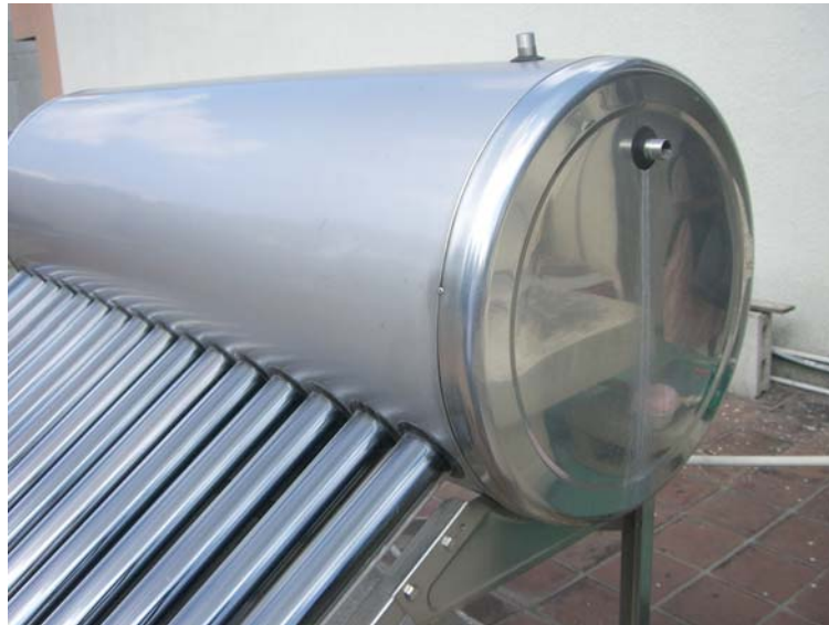
Figura 2.11 Vista del tanque de un sistema termosifón
