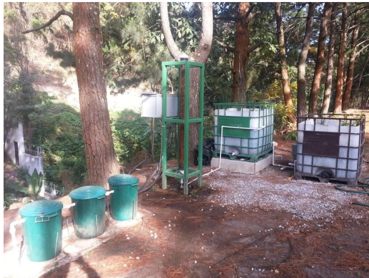
Ilustración 40: Planta de tratamiento con sistemas naturales, ubicada en las instalaciones del Edificio de los Colegios Profesionales.
