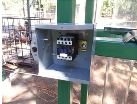
Ilustración 31: Caja de interruptores de corriente general, con un interruptor de corriente instalado de 40 A, 240 V.
