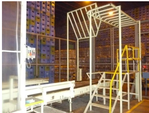
Figura 51. Últimos transportadores del transporte de palé del salón de embotellado #3
