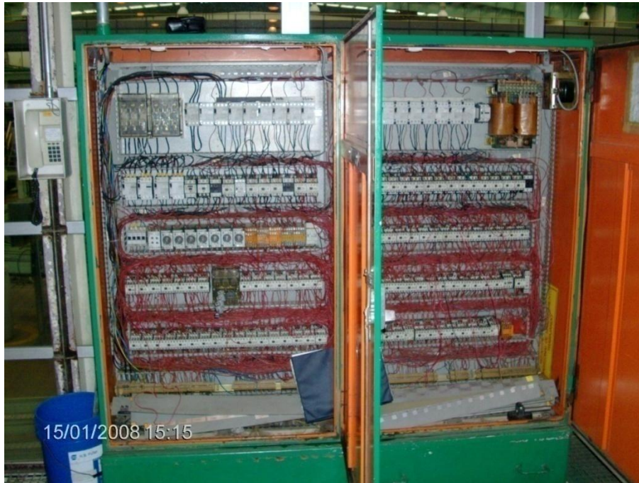
Figura 56. Armario del panel eléctrico del proceso.
