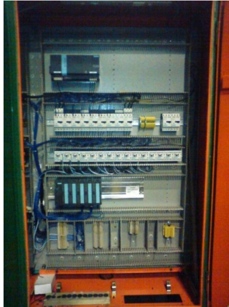
Figura 64. Parte derecha del panel eléctrico nuevo
