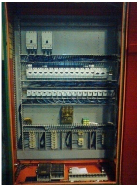
Figura 63. Parte izquierda del panel eléctrico nuevo
