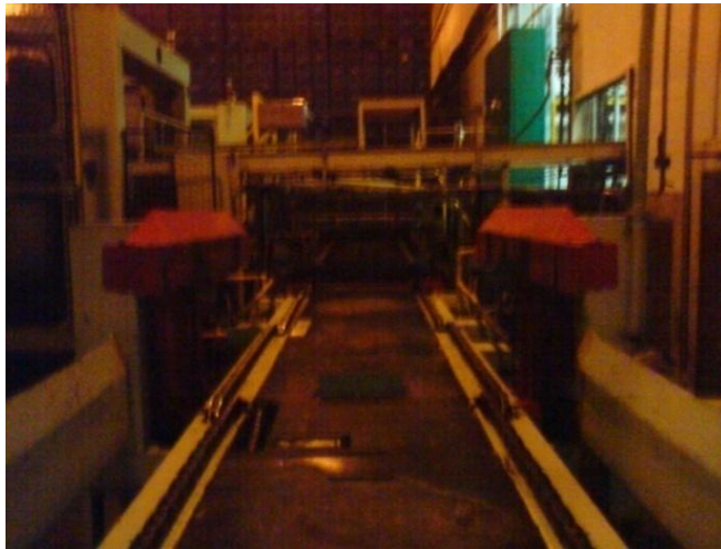
Figura 52. Vista desde el último transportador del almacén de palé hacia el primer y segundo inversor
