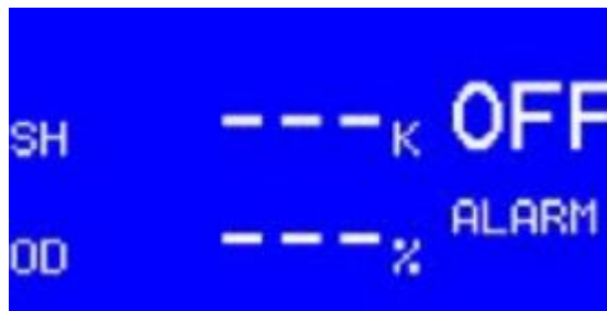
Figura 47. Pantalla del control de sobrecalentamiento en modo apagado de la interfaz Danfoss MMIMYK [7]
