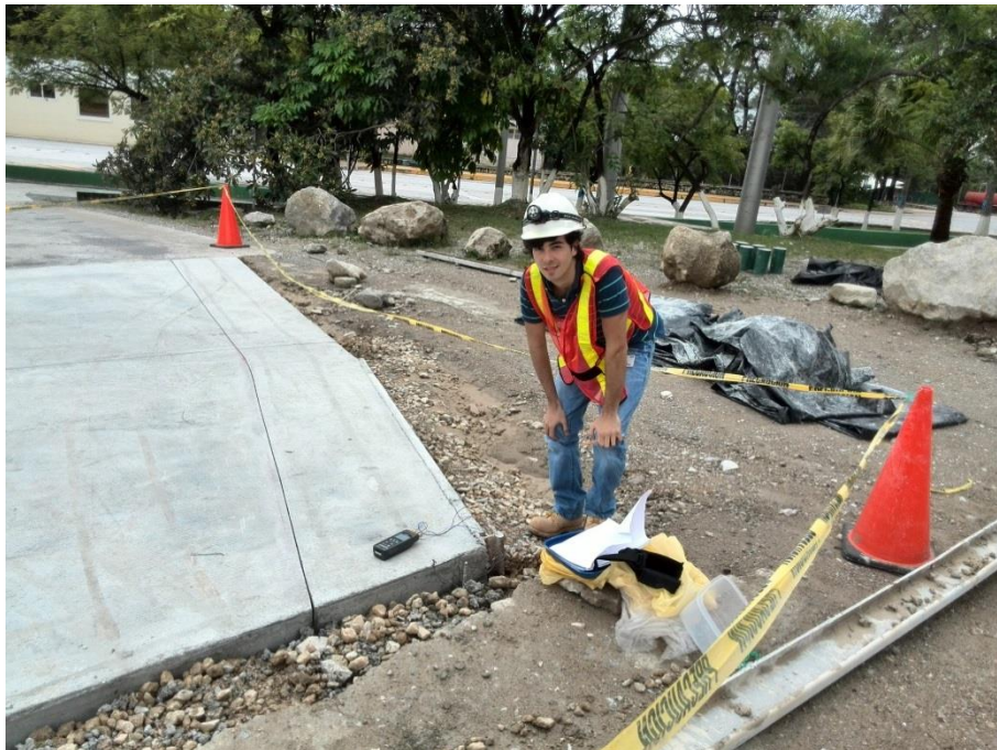
Figura No. 253. Equipo colocado en campo.
