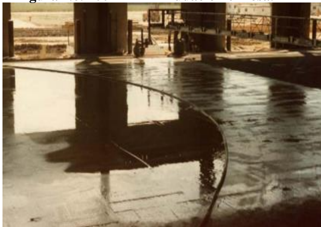
Figura No. 100 Exudación en losa.
