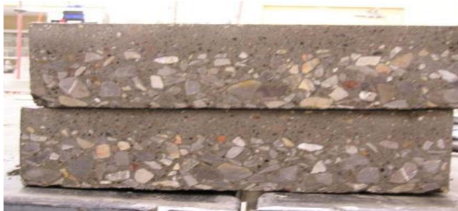
Figura No. 99 Segregación en el concreto.
