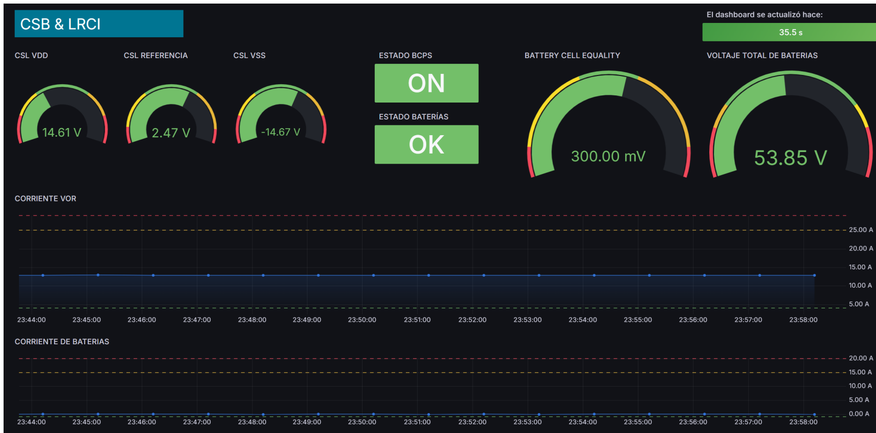
Figura 18: Tablero de lecturas de CSB y LRCI
