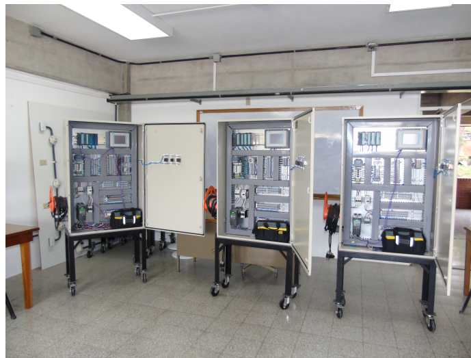
Figura 1: Tableros industriales del laboratorio de instrumentación y automatización.
