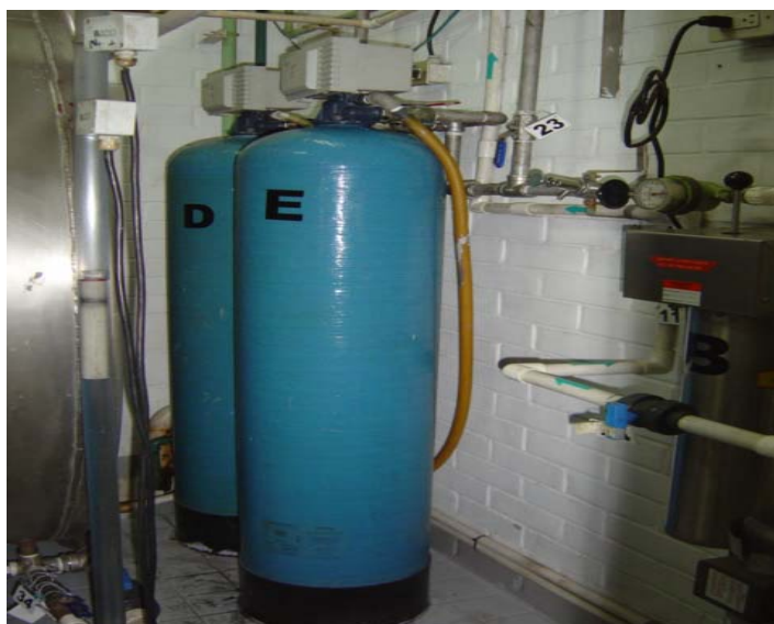
Figura No. 2. Filtro de arena y filtro de carbón
