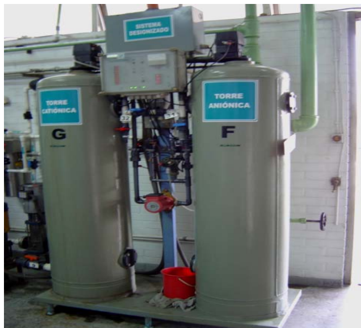
Figura No. 3. Sistema desmineralizador, Torre G: resina catiónica , Torre F: resina aniónica
