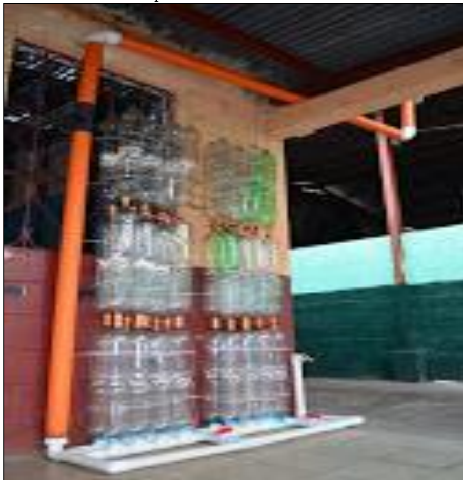
Figura 36. El Sistema de captación de agua de lluvia utilizando Eco-Muros para su almacenamiento.
