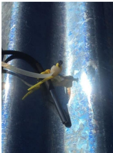
Figura No.85. Termocupla uno instalada en el exterior del techado de lámina galvanizada.
