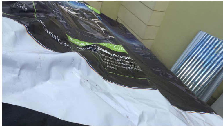
Figura No. 67. Orientación de la impresión de la manta vinílica sobre la estructura de techado
