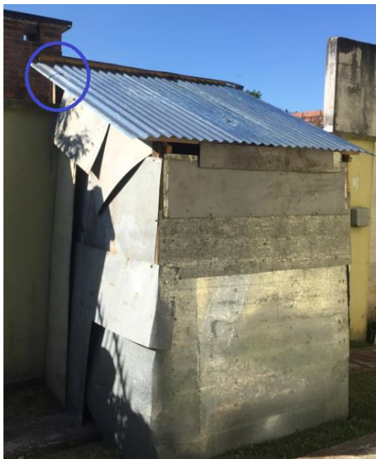
Figura No.84 Termocupla uno en el exterior del techado de lámina galvanizada.
