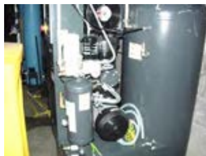
Figura 10: Interior derecha de compresor
