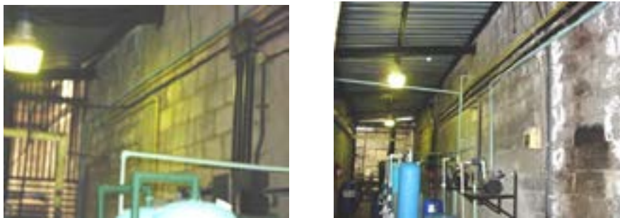
Figura 30: Distribución de tubería dentro del cuarto de máquinas
