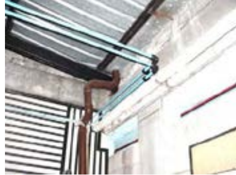
Figura 18: Tubería a la salida del cuarto de máquinas hacia distribución
