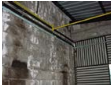
Figura 31: Distribución de tubería dentro del cuarto de máquinas
