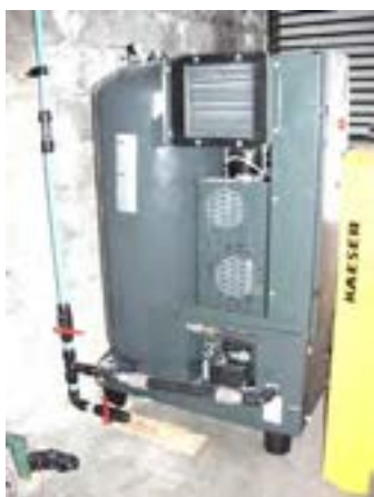
Figura 11: Interior izquierda del compresor
