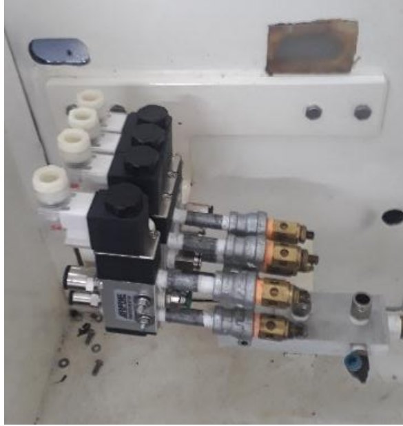
Figura 71: Instalación de electroválvulas
