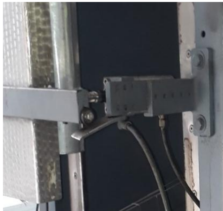
Figura 8: Daño en guía de sellador vertical
