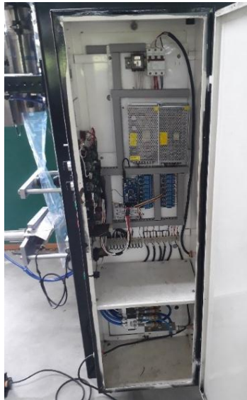
Figura 102: Armario de control después del rediseño
