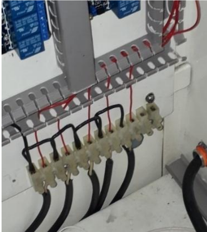
Figura 77: Conexión de electroválvulas
