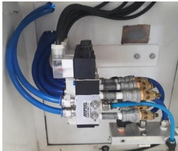
Figura 72: Conexión de electroválvulas
