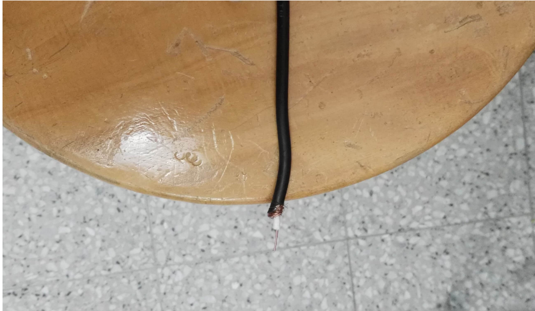
Figura XI.46: Cable coaxial expuesto colocado en el lugar en donde se realizarán las mediciones con la antena dipolo, a una altura de 65 cm.
