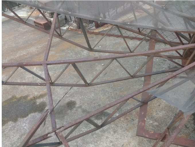
Figura XII.2: Corrosión que sufre la antena.
