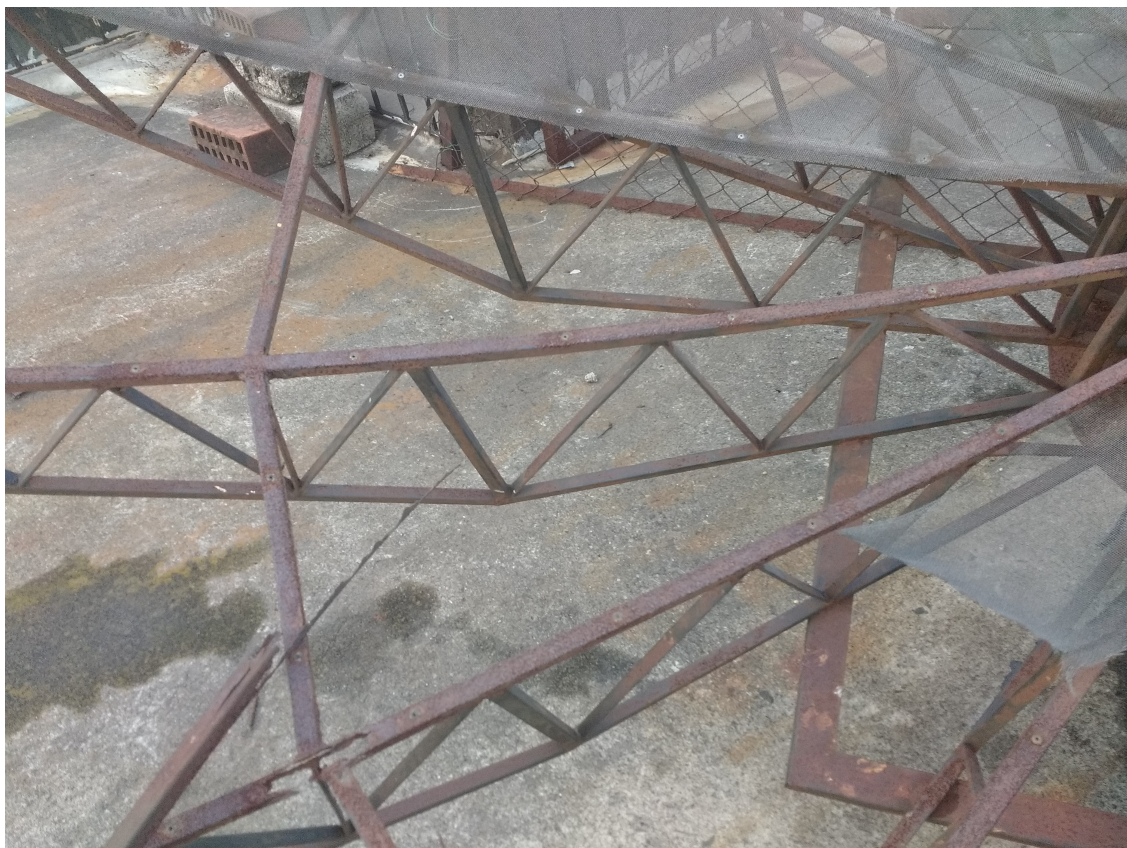
Figura XII.5: Mal estado de los pétalos de la antena recibida por donación.
