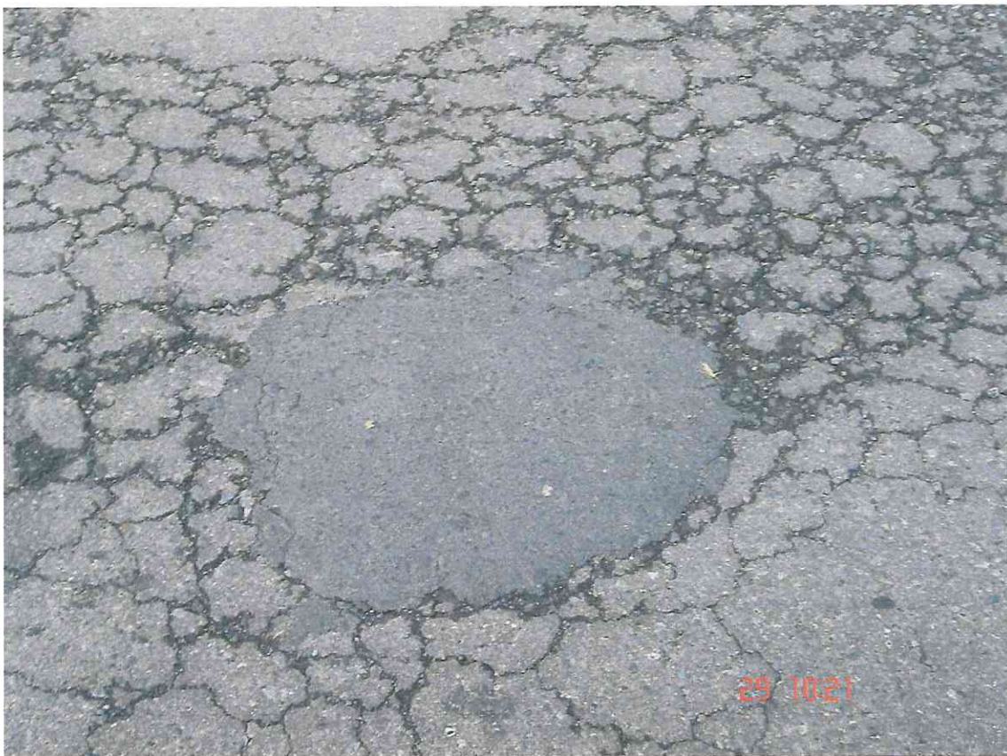
Foto 2. Grietas en el pavimento y bache previamente reparado
