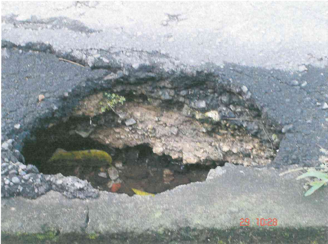
Foto 7. Desintegración tanto del pavimento como de la base
