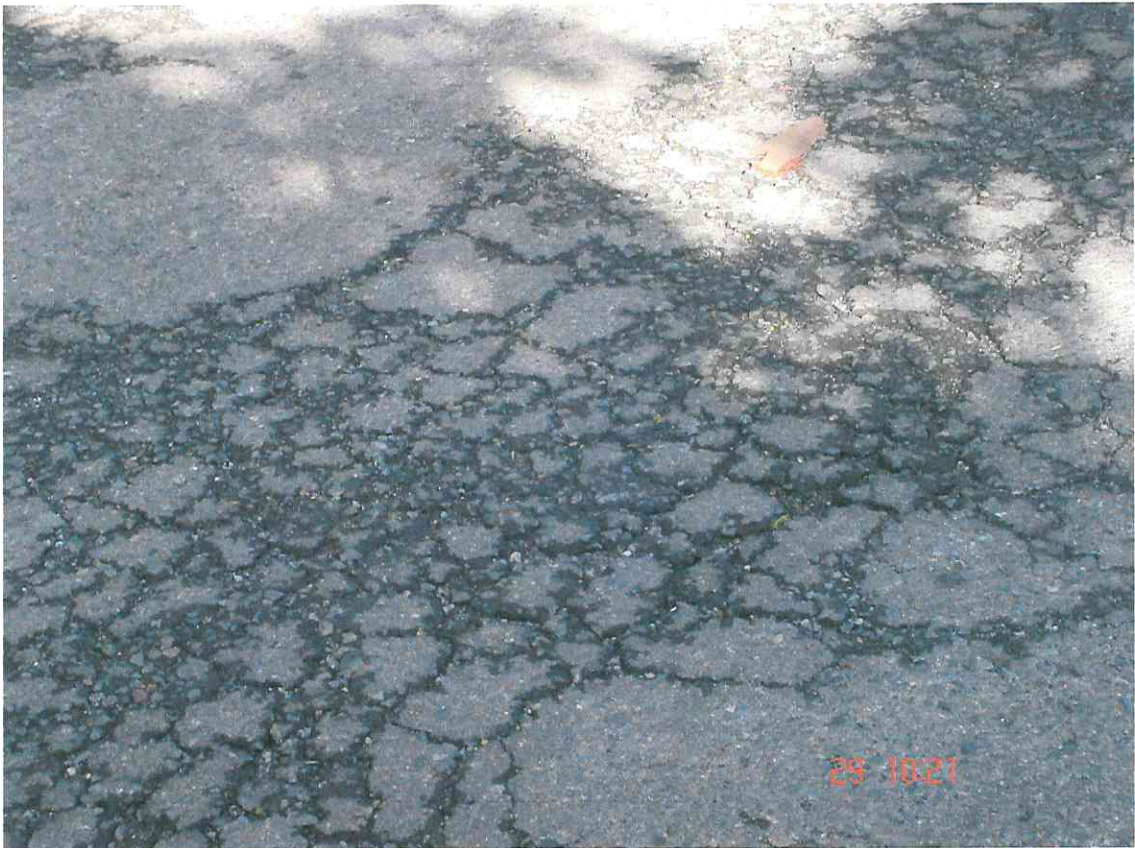
Foto 3. Grietas en el pavimento
