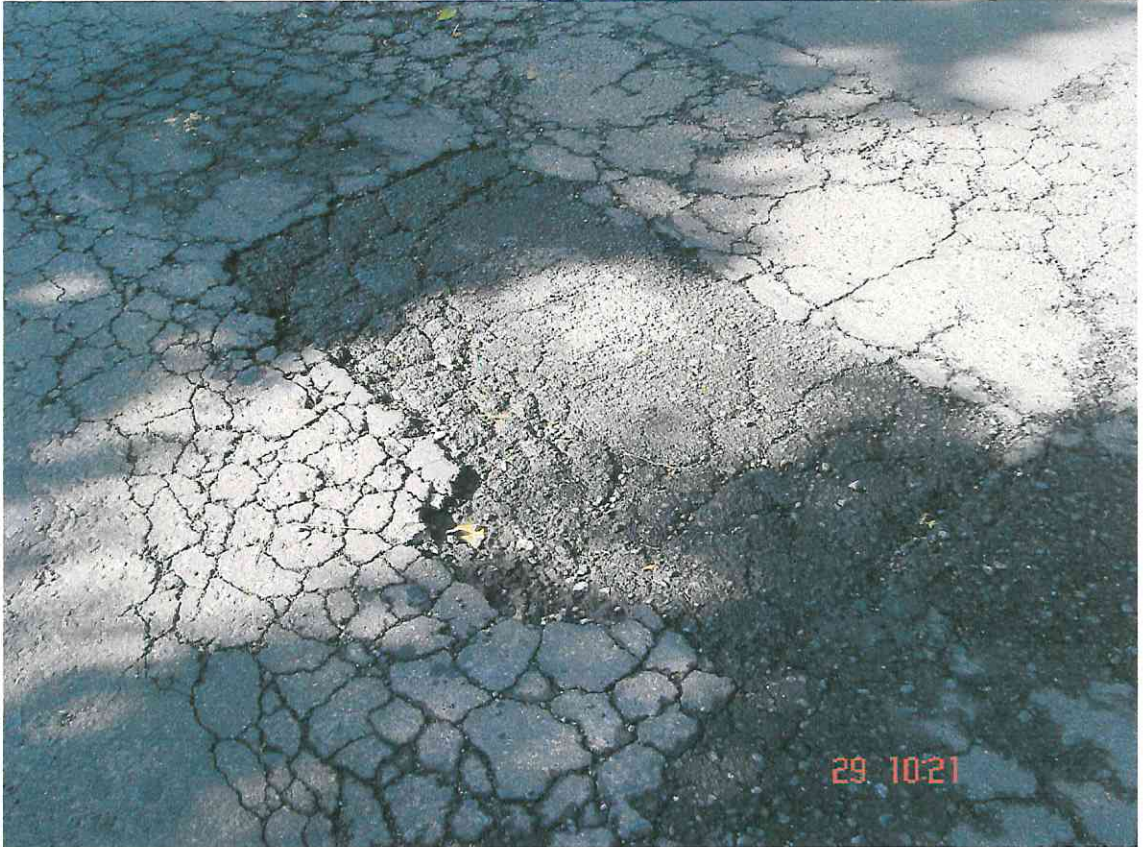
Foto 4. Grietas en el pavimento y bache previamente reparado
