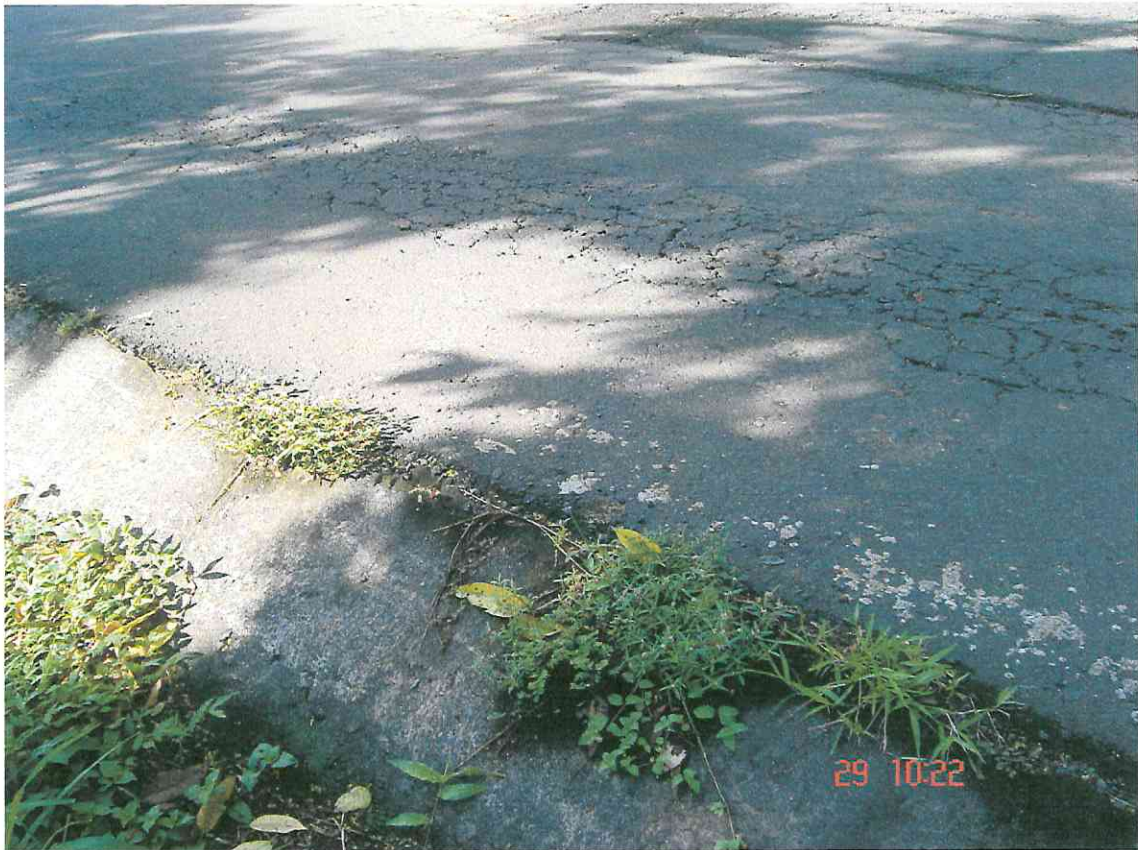
Foto 5. Grietas en el pavimento y cuneta existente
