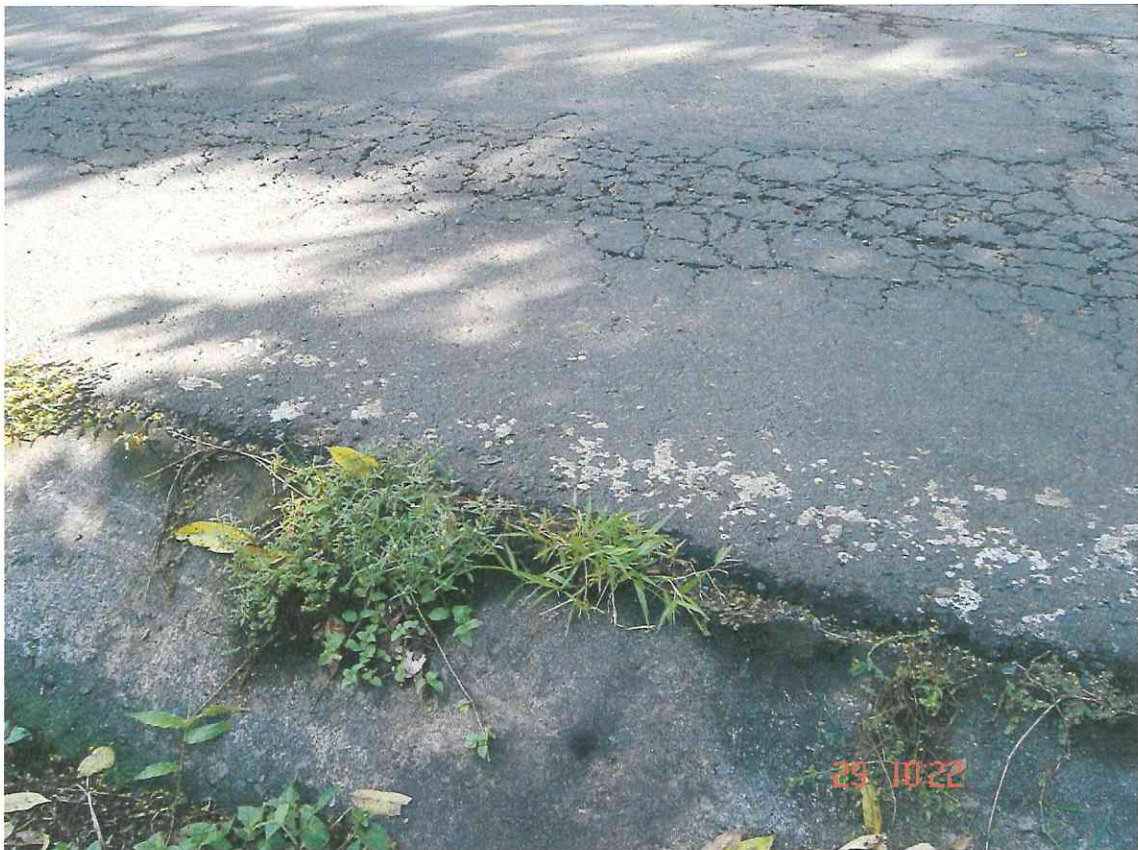
Foto 6. Grietas en el pavimento y cuneta existente
