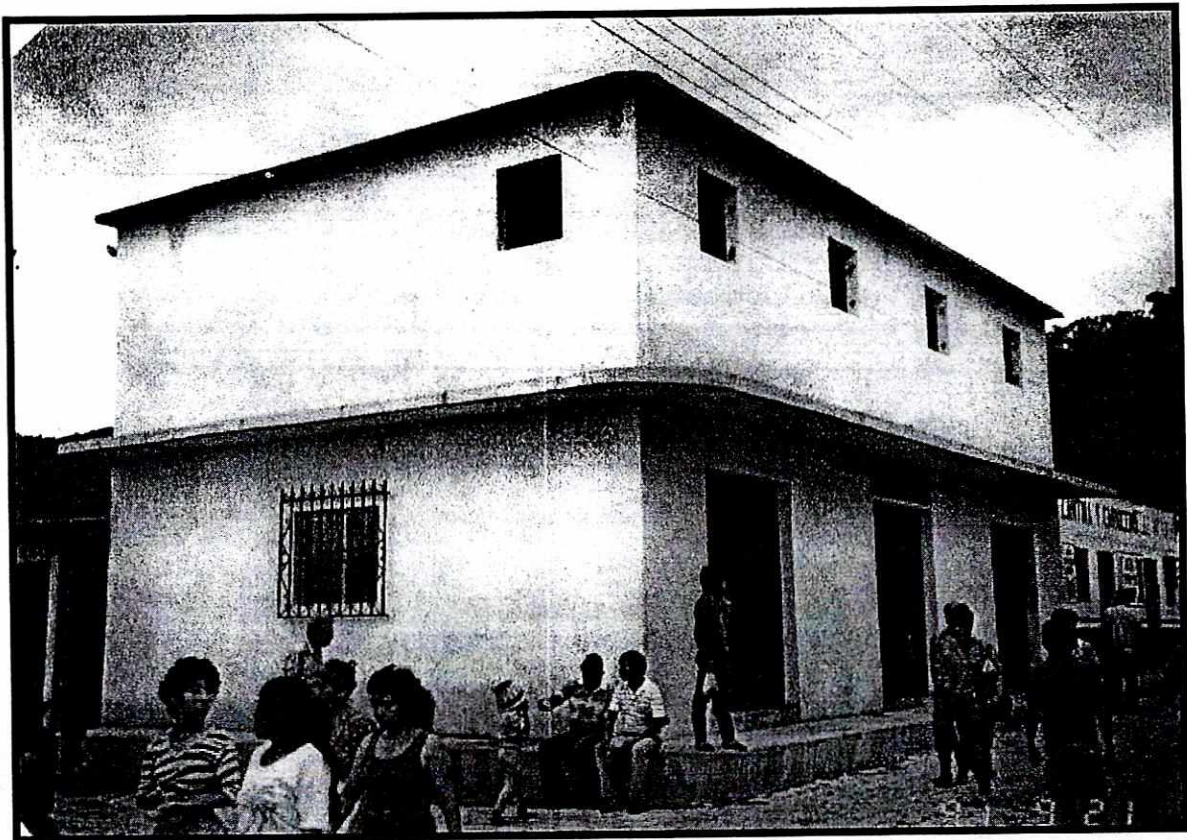
Casa de dos niveles de mampostería reforzada sin daño alguno, Pochuta, 1991 (Foto, M. Matus)
