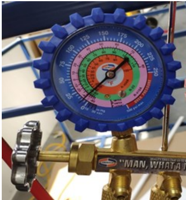
Figura 59: Presión de entrada al evaporador
