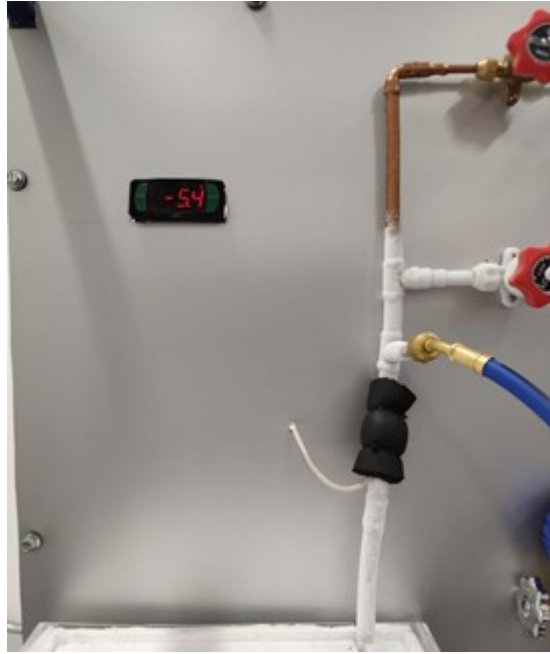
Figura 61: Registro de temperatura en la entrada del evaporador (sensores)
