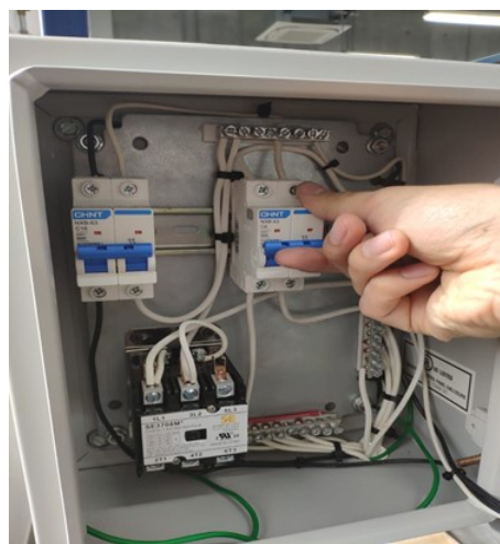
Figura 70: Activación de interruptores termomagnéticos
