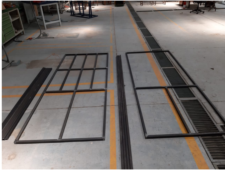
Figura 32: Finalización de la soldadura del primer y último nivel de la estructura
