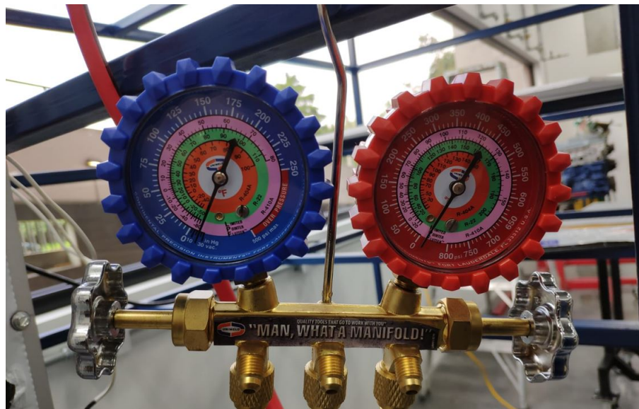
Figura 55: Medición de presión de vacío en el sistema
