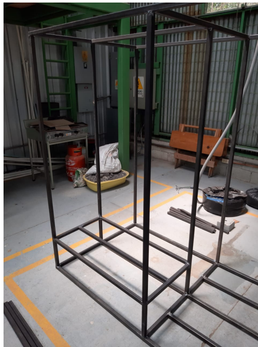
Figura 33: Estructura para montaje del sistema de refrigeración
