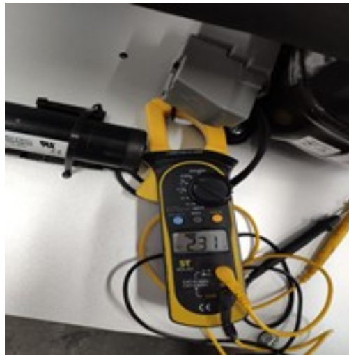
Figura 58: Verificación del consumo de corriente del compresor
