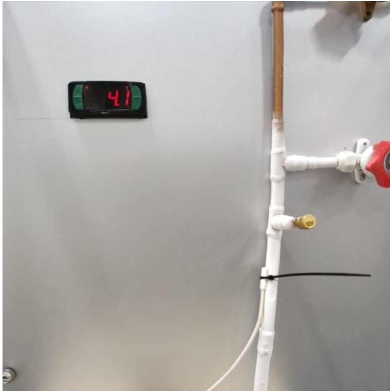
Figura 67: Registro de temperatura en la salida del evaporador con sensor sin aislamiento térmico
