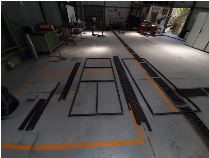
Figura 29: Corte de tubería y posicionamiento del primer y último nivel del sistema de transferencia de calor
