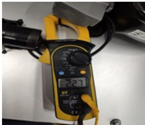
Figura 57: Medición de corriente de operación del compresor
