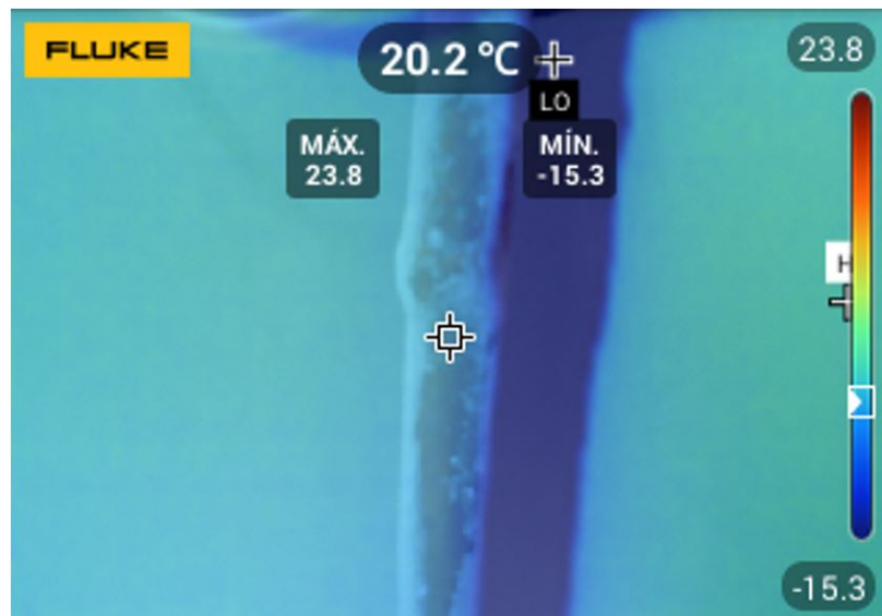
Figura 62: Registro de temperatura en la entrada del evaporador (termografía)
