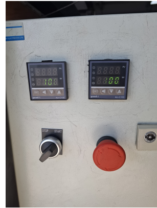
(b) Vista externa de la caja eléctrica
