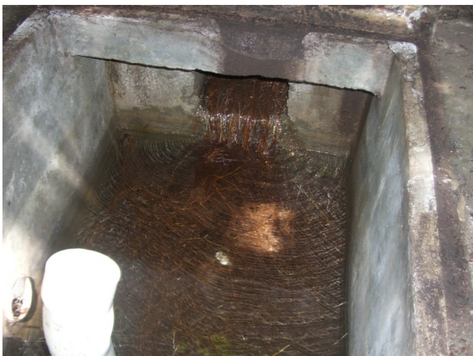
Ilustración 8 Caja de captación No. 3, Manantial "Las Nubes"
