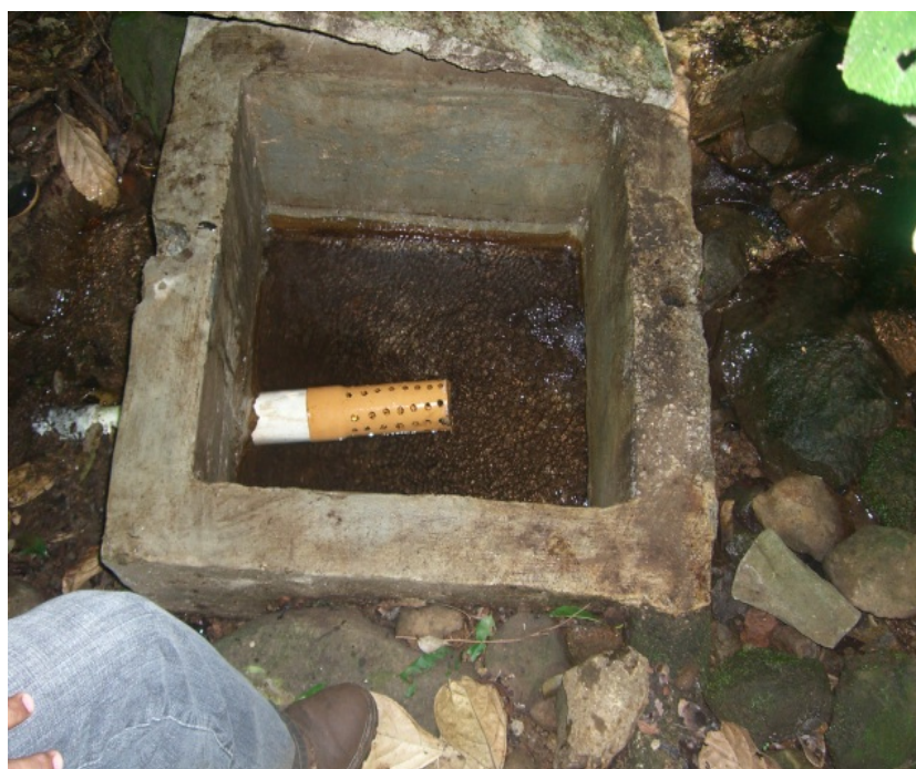
Ilustración 9 Caja de captación Manantial “Vuelta Grande”
