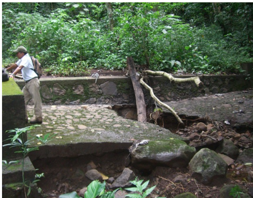
Ilustración 12 Daño a la losa del sistema de captación Manantial “Santa Rita”
