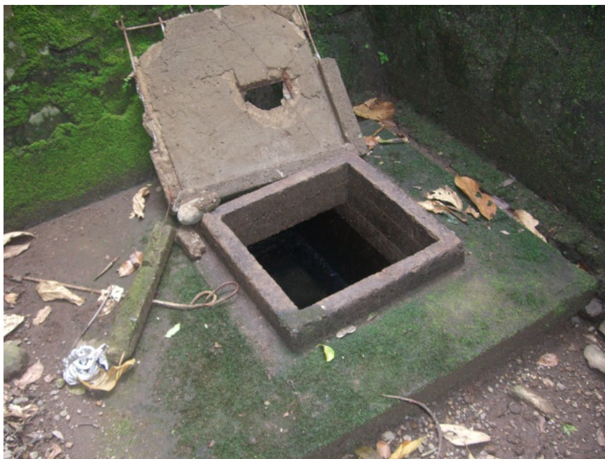
Ilustración 11 Caja unificadora Manantial “Santa Rita”
