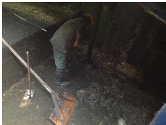
Figura 26. Mantenimiento correctivo, alta acumulación de bagazo y agua (tándem A)
