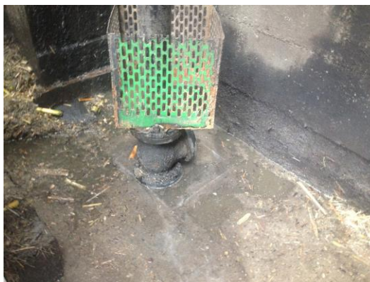
Figura No. 3 Nivel de bagazo acumulado adecuado y no adecuado en el área de la bomba succionadora del Tándem A
