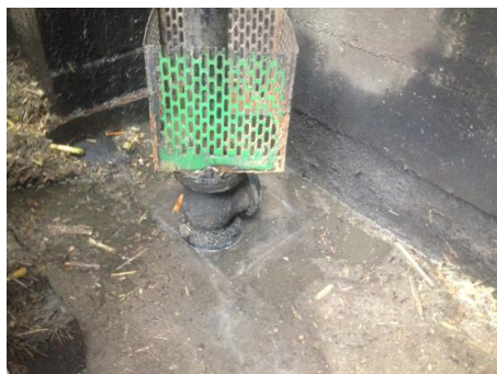
Figura 23. Inadecuado mantenimiento de bomba succionadora (tándem A)
