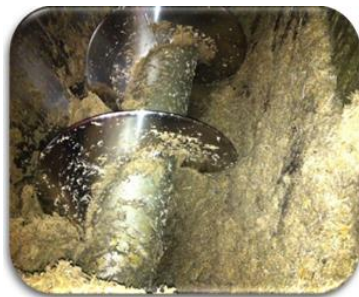
1. Bagazo estancado en tornillo transportador en tándem B
