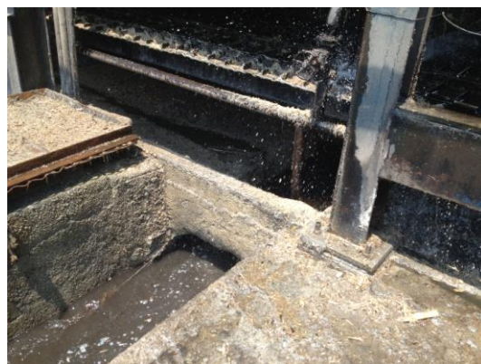
Figura 34. Desagüe (tándem C).
