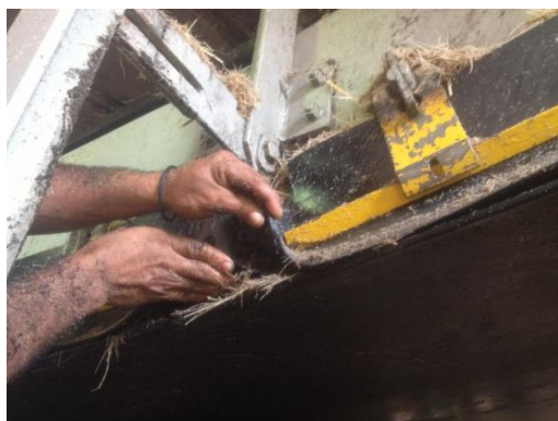
Figura 30. Fallas en los selladores de la banda.
