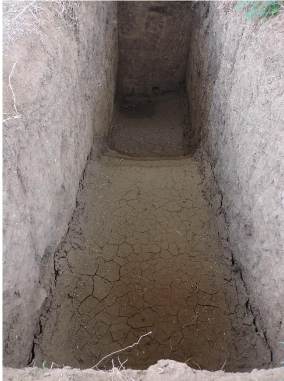
Figura III-7: Fotografía realizada el 26 de abril de 2019 donde se observa el agrietamiento del recubrimiento (Foto por P. Estrada).
