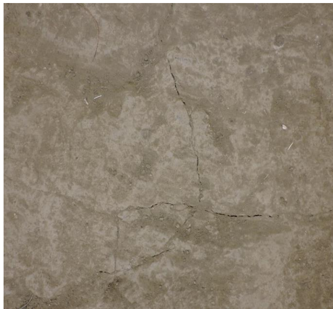
Figura III- 3: Agrietamiento del piso del Preclásico Medio por su exposición directa al sol (Foto por P. Estrada).
