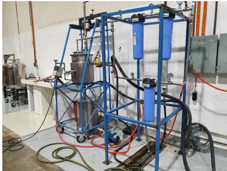
Figura 25. Planta de cerveza instalada
