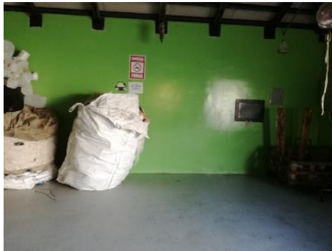
Figura 119: Riesgo por caídas a distinto nivel
