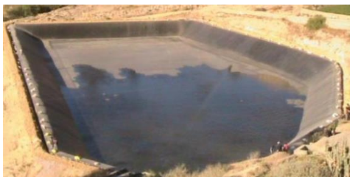
Figura 20. Sistema de captación de agua de lluvia con geomembrana
