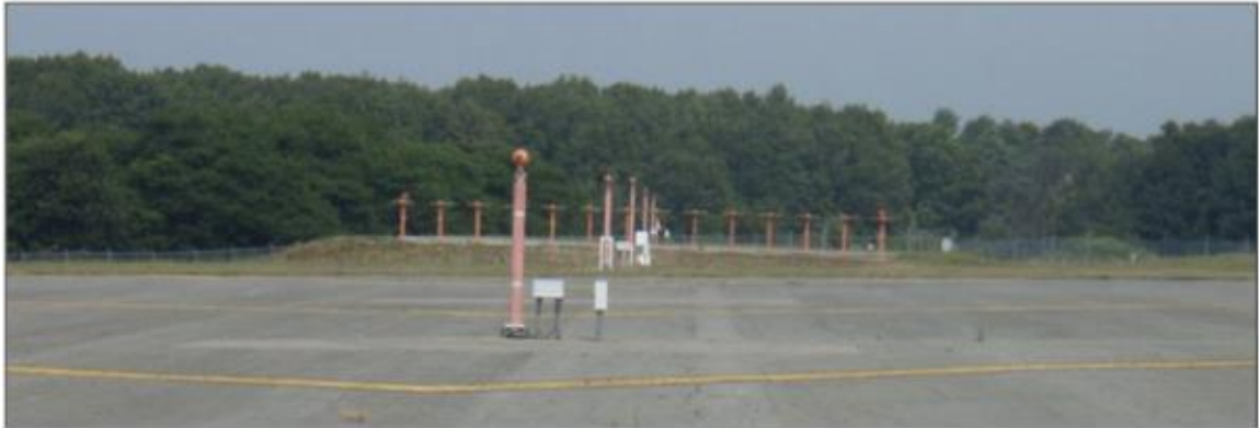
Figura 22. Instalaciones de LDIN.
