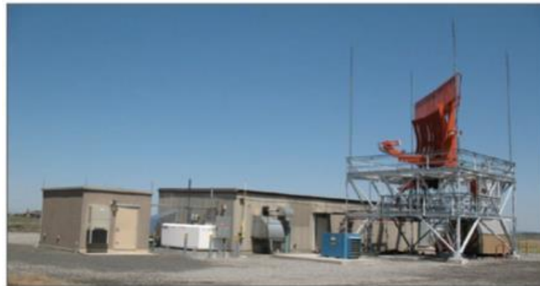
Figura 11. Radar de vigilancia del aeropuerto (ASR). Torre de 5 m de altura.
