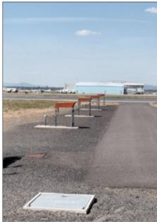
Figura 25. Cajas de iluminación PAPI.
