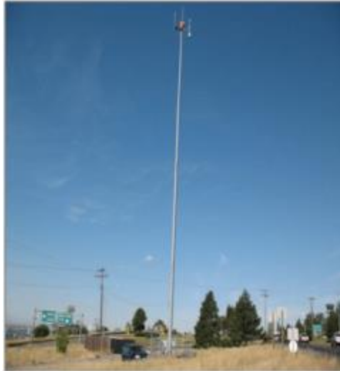
Figura 39. Poste con sensores de Sistema de alerta de cortante del viento a bajo nivel (LLWAS).
