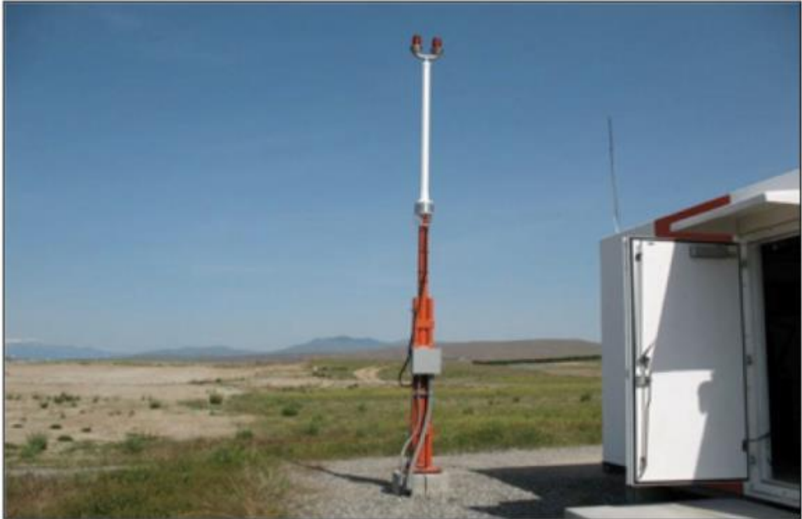
Figura 29. Antena de equipo de medición de distancia (DME).
