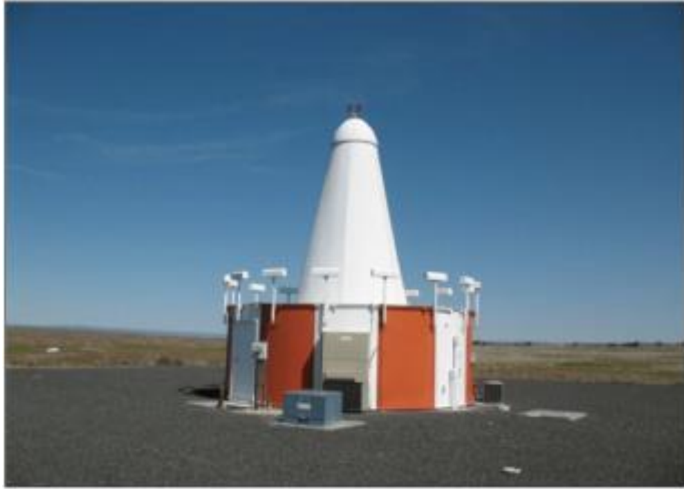
Figura 31. Instalación de VOR en terminal (TVOR).
