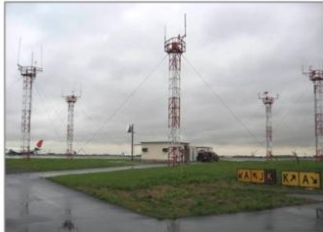
Figura 10. Instalaciones de comunicación de Transmisor-receptor remoto (RTR)
