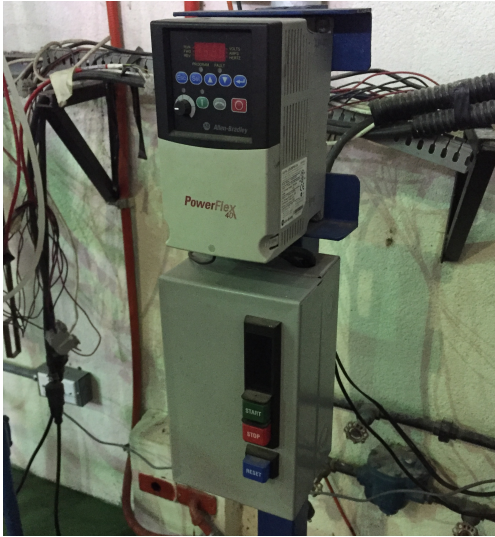
Figura 8. Variador de frecuencia instalado fuera del panel.
