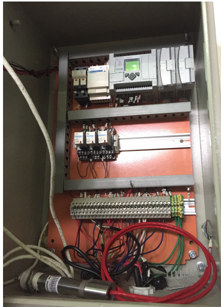
Figura 6. Panel de control de la columna de extracción con el sensor de conductividad dentro del mismo.
