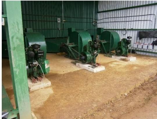
Ilustración 13 Unidades de potencia secadores rectangulares fuera del recinto de secado
