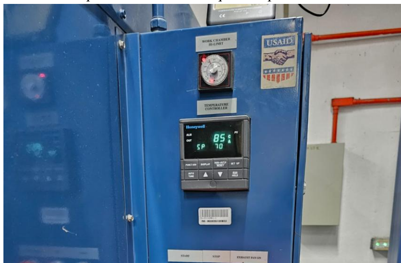
Figura 89. Aumento de temperatura en el arranque de operación.
