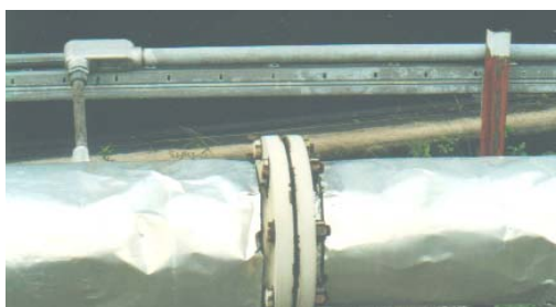
Foto No. 45: Tubería dañada
