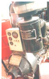
Foto No. 30: Bomba para despachos de combustible.
