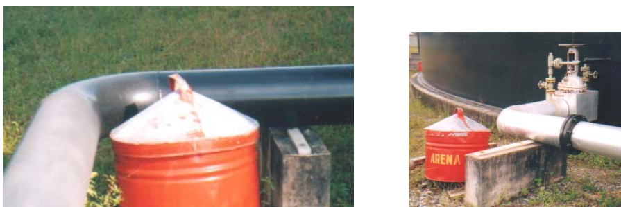
Foto No. 42: Tapaderas deformada y despintada
