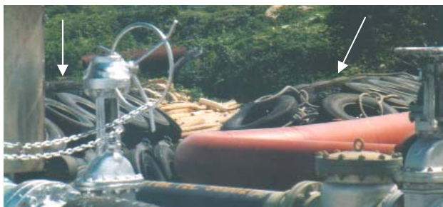
Foto No. 40: Grandes boyas detrás de tuberías.
