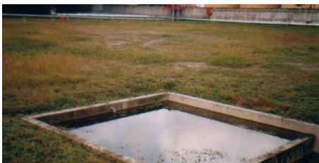
Foto No. 56: Pileta separadora.
