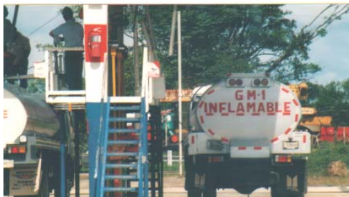
Foto No. 48: Extintor a la par de las gradas en el área de carga de gasolinas y diesel.
