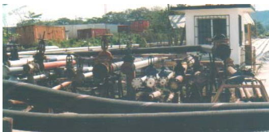
Foto No. 36: Entradas de aproximadamente 15 tuberías desde el muelle.
