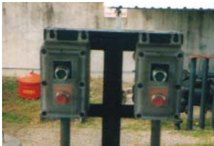
Foto No. 26: Interruptores de carga.
