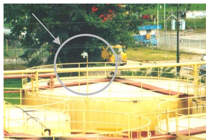
Foto No. 18: Planta vecina con postes de alumbrado eléctrico sobre los tanques.
