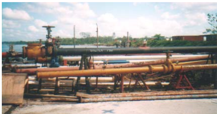
Foto No. 35: Tuberías de descarga en el muelle de Santo Tomás de Castilla.
