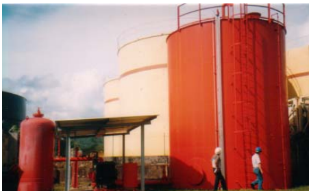
Foto No. 52: Tanques de agua y espuma
