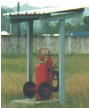
Foto No.49: Extintor conocido como robot.
