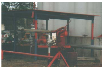
Foto No. 51: Extintor descompuesto.
