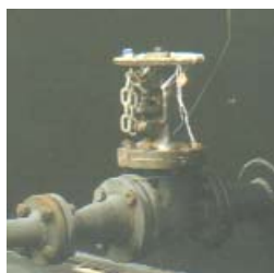
Foto No. 13: Válvula de salida con obstrucciones.
