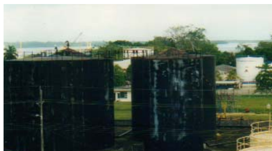
Foto No. 2: Planta vecina con tanques oxidados y visiblemente deteriorados.
