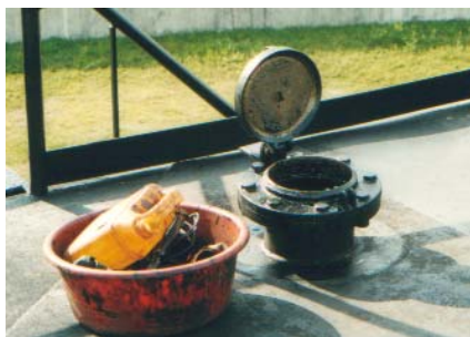
Foto No. 20: Equipo de medición.
