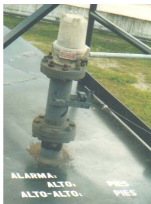
Foto No. 5: Alarma de nivel y rótulo incompleto.
