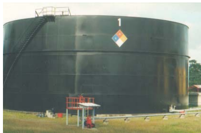
Foto No. 3: Rombo de seguridad en tanque de bunker.
