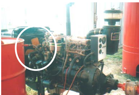
Foto No. 32: Ventilador de bomba expuesto
