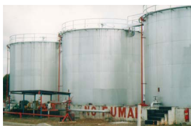
Foto No. 53: Señales de no fumar
