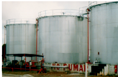
Foto No. 8: Tanques de gasolinas y diesel sin identificación.
