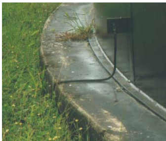
Foto No. 19: Tierra física.
