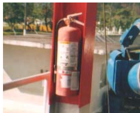
Foto No. 47: Extintor en área de carga.
