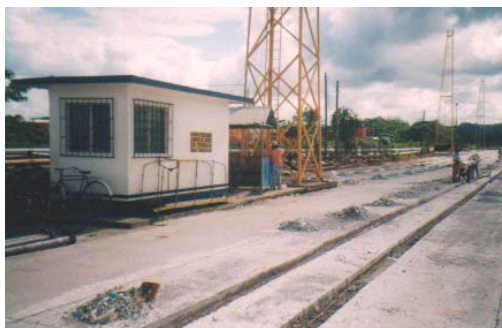
Foto No. 41: Construcción sin supervisión adecuada a la par de las tuberías.
