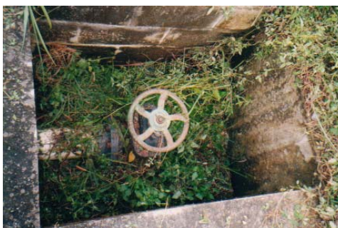
Foto No. 57: Llave de emergencia para liberar el combustible a otra área.
