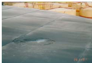
Foto No. 46: Techo de bunker abollado.
