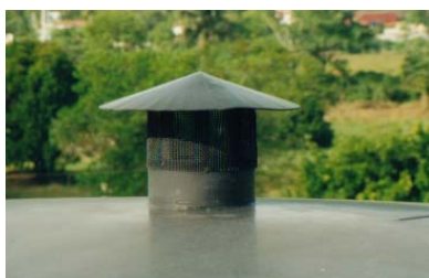
Foto No. 10: Chimenea de respiración de los tanques.
