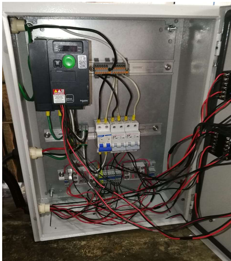
Figura 5. Panel eléctrico antes de intervención
