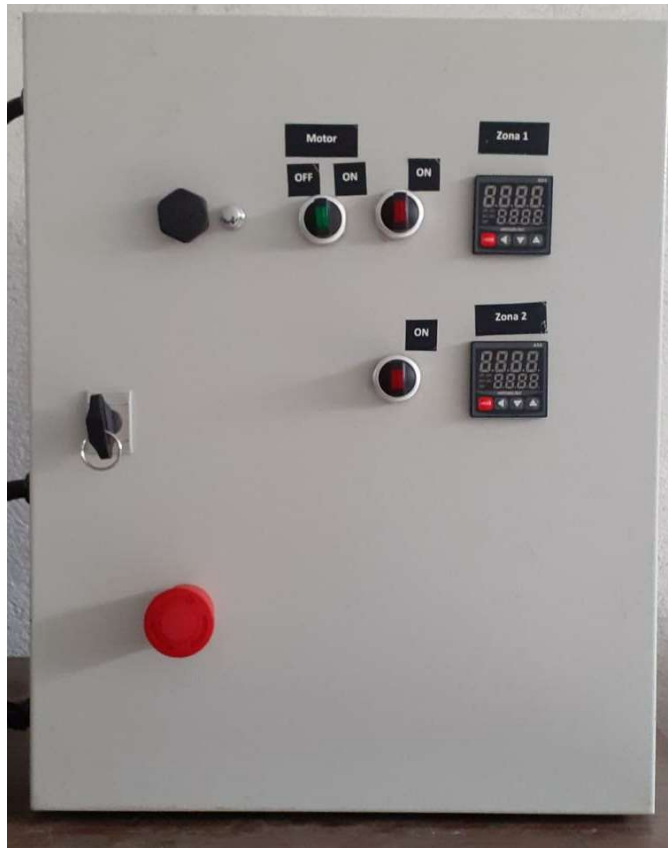
Figura 7. Panel eléctrico cerrado con botón de emergencia en posición modificada
