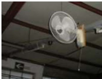
Figura # 17: Ventiladores en área de trabajadores
