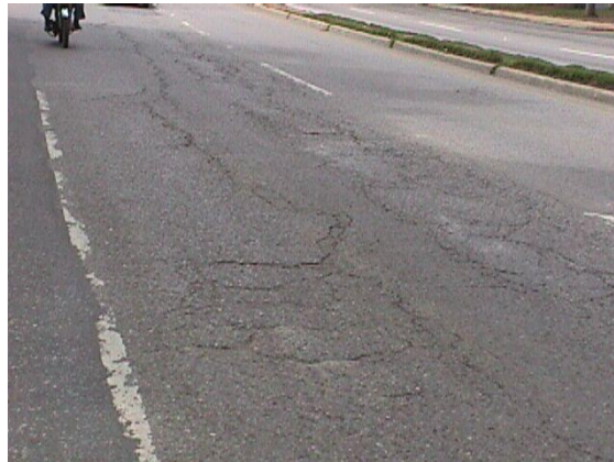
Ilustración 9. Hundimiento de la superficie del pavimento (surcos).
