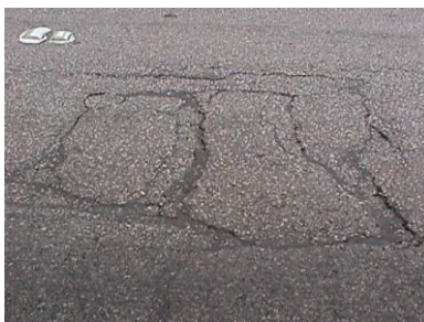
Ilustración 6. Fisuración en bloque.
