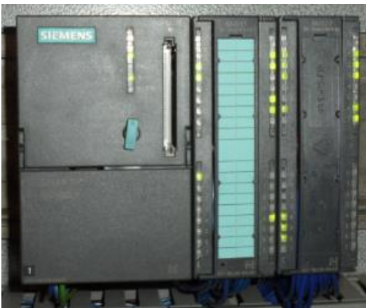
Figura 31: Estados de señales de entrada y de salida del PLC S7-300
