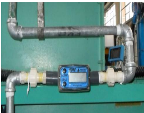
Ilustración 53. Rotámetro de la torre de enfriamiento
