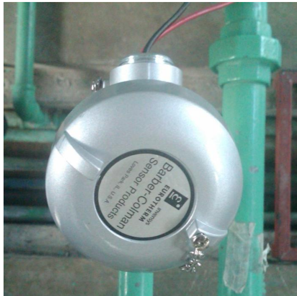
Ilustración 59. Sensor RTD instalado en la salida de agua de la torre
