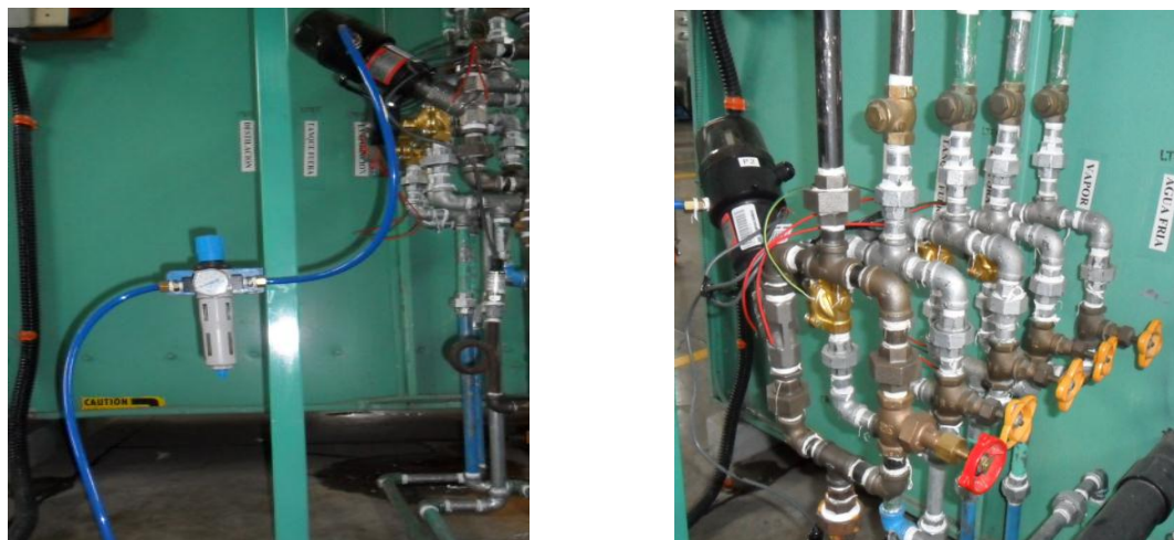
Ilustración 52. Estructura del nuevo Manifold que controla la torre de enfriamiento
