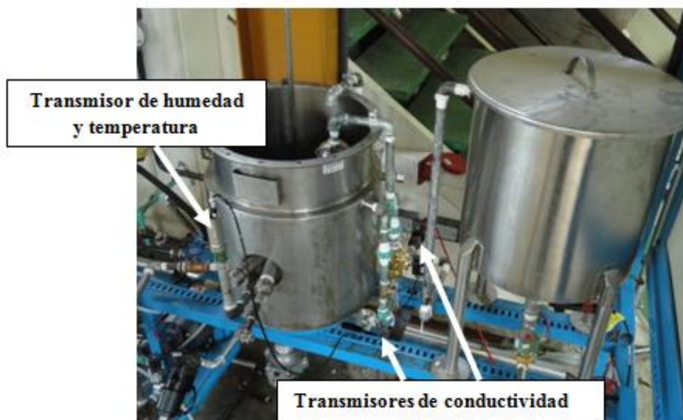
Ilustración 31. Válvulas e instrumentación en el tanque de tratamiento de biodiesel
