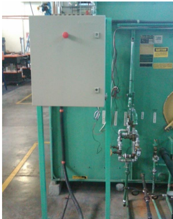
Ilustración 58. Gabinete instalado en la torre de enfriamiento
