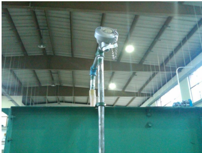
Ilustración 48. Sensor RTD colocado en la entrada de agua de la torre
