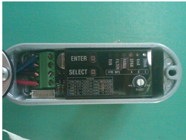
Ilustración 65. Interior del Sensor de velocidad de Aire con las conexiones en bornera
