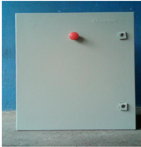
Ilustración 57. Exterior del gabinete mostrando el botón de paro de emergencia
