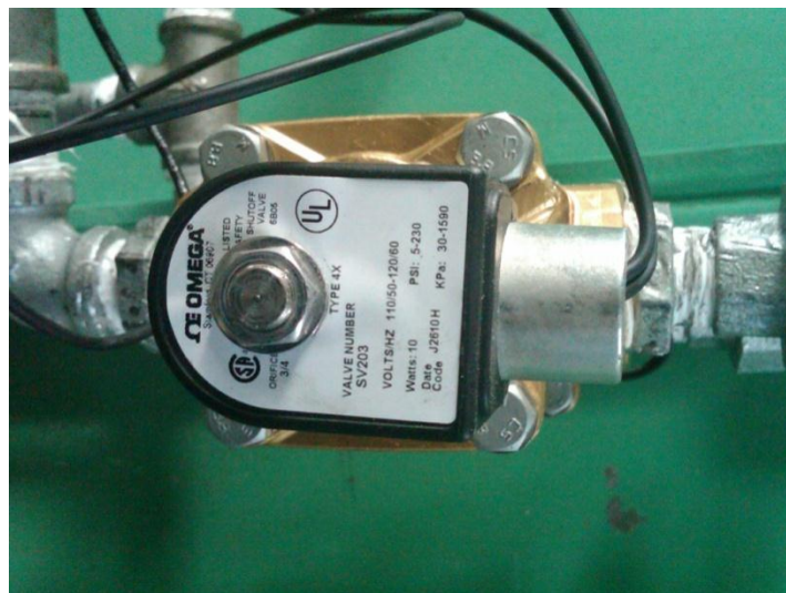
Ilustración 67. Válvula ON-OFF utilizado para la entrada de agua a la torre
