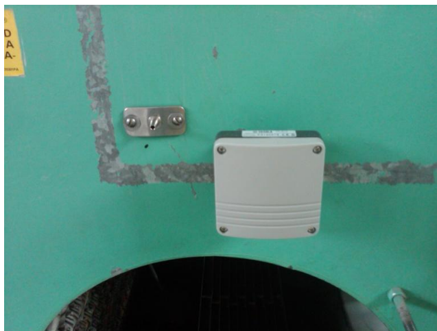
Ilustración 49. Sensor de humedad y temperatura (derecha) junto al tubo donde se obtiene la presión del aire de la torre en la entrada frontal
