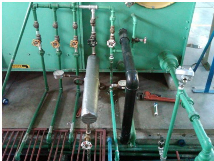
Ilustración 46. Modificación realizada sobre tubería de salida de agua
