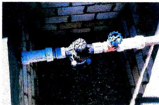
FILTRO DE AGUA
