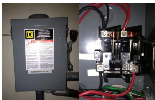
Figura 5 Fotografía de desconexión AC
