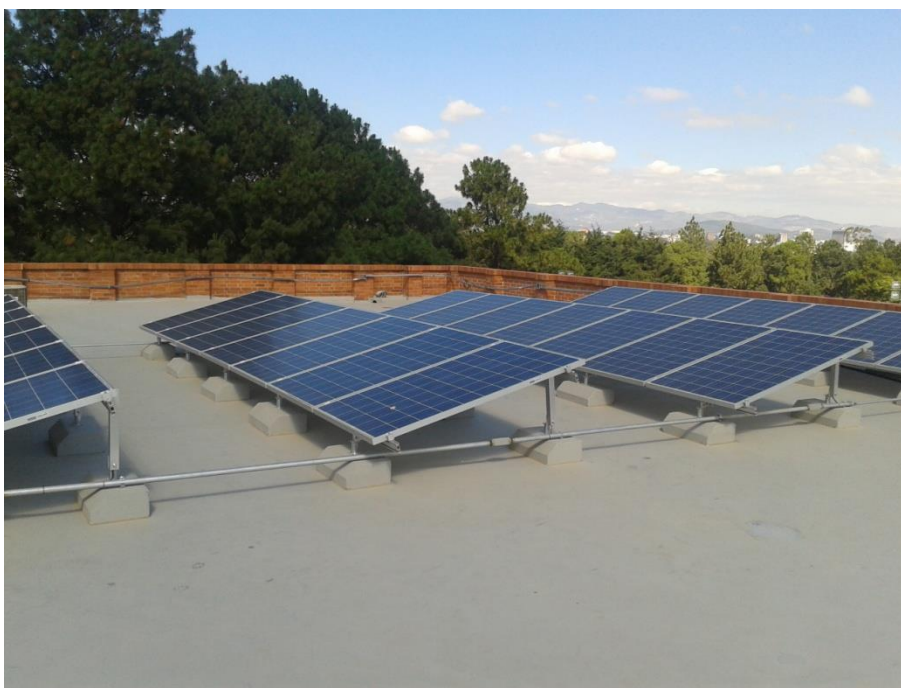
Figura 2 Fotografía de generador fotovoltaico
