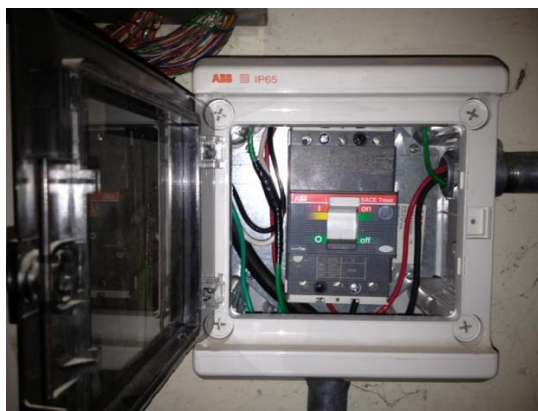
Figura 4 Fotografía de interruptor DC
