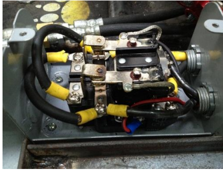
Figura 59: Relé de reversa instalado
