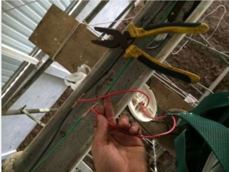
Figura 15. Conexión de bombillos incandescentes de 25 Watts
