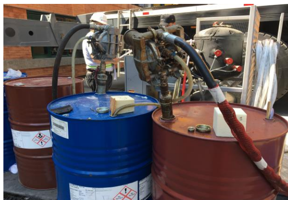
Figura 6. Sistema de bombeo por medio de bomba de diafragma
