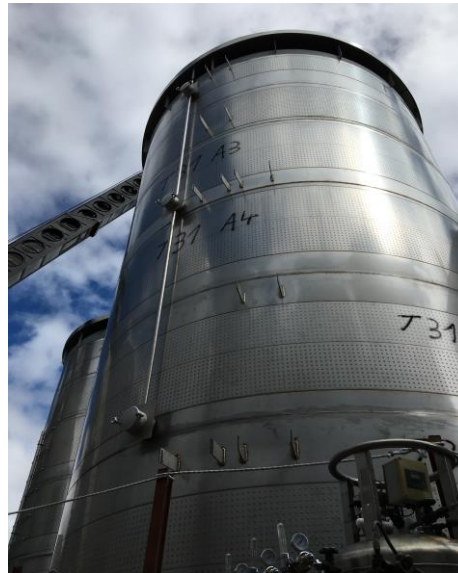
Figura 14. Cajas para sensores colocados en tres anillos del tanque
