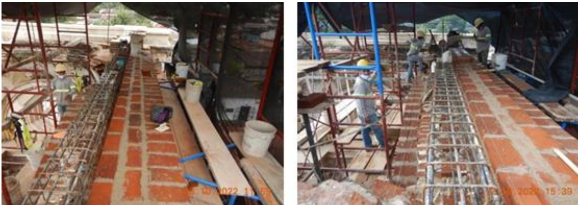
Figura 8. Integración de solera de amarre conformado por varillas de acero, Templo de la Concepción.
