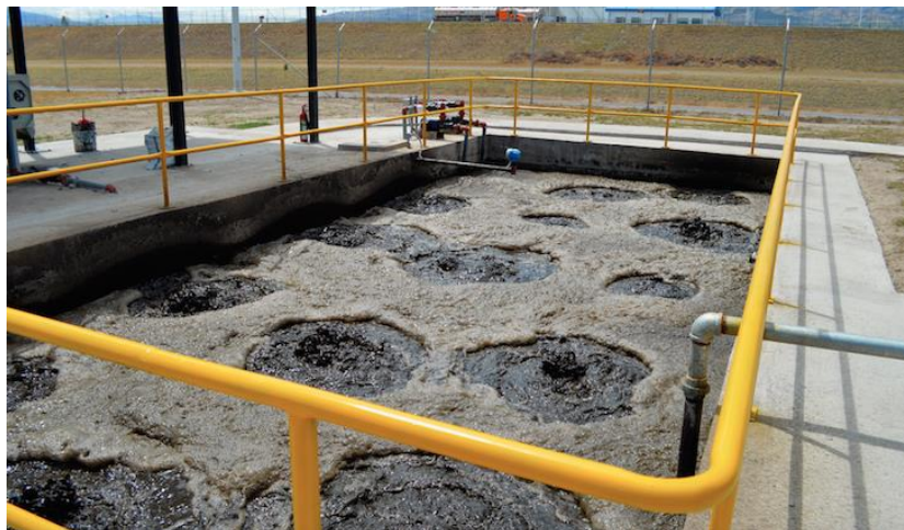
Figura 72. Reactor de lodos activados
