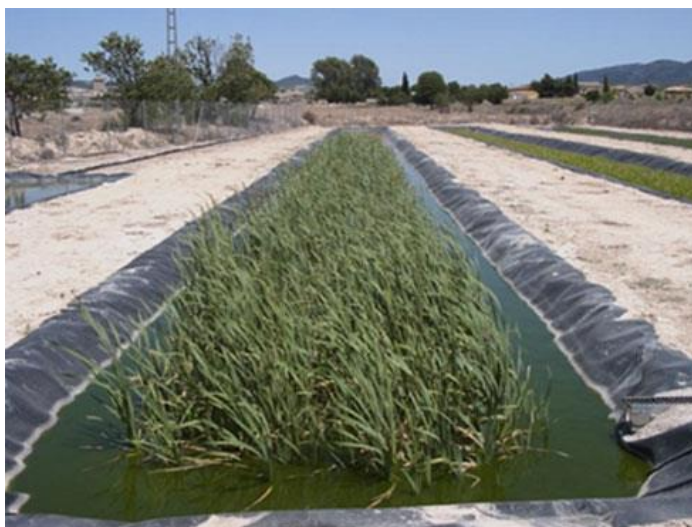
Figura 70. Humedal de tratamiento secundario
