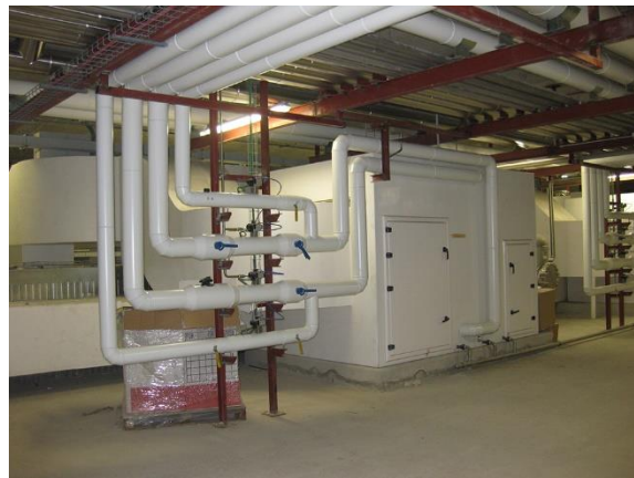
Figura 42. Tubería de distribución de agua potable expuesta en una edificación
