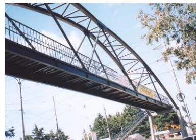
Foto No.8 puente peatonal Km 16 Carretera a El Salvador Fuente: foto digital Arq. Ortiz
