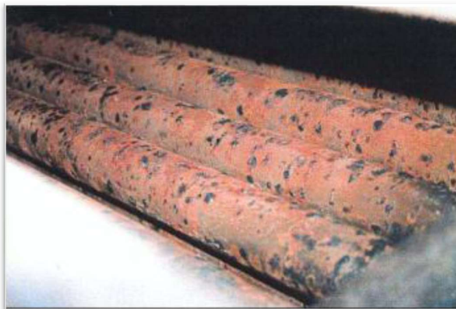
Figura 38 Ejemplo de corrosión por oxígeno
