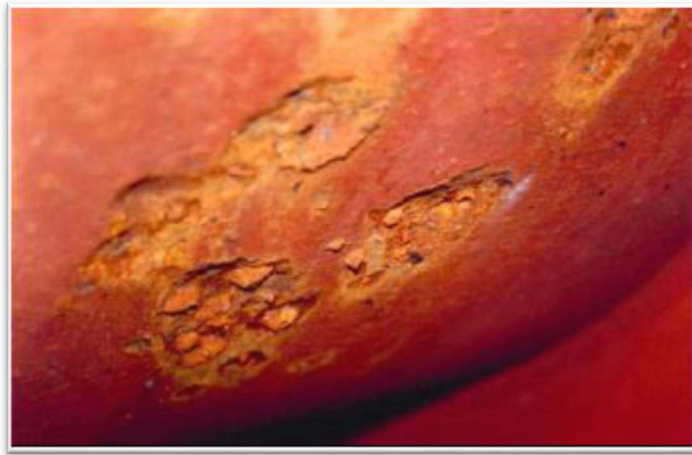
Figura 39 Ejemplo de corrosión cáustica
