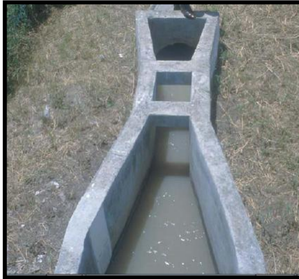
Ilustración 201. Medidor de caudal Parshall fabricado de concreto
