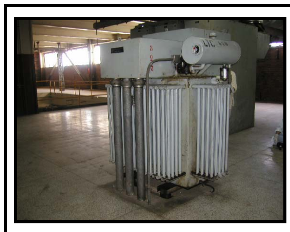
Transformador marca PIVI Milano, 450 KVA
