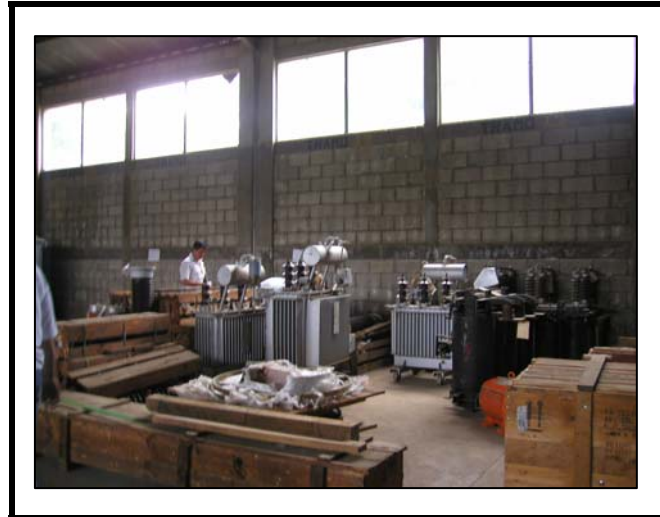
Figura 5 Transformadores con PCB en la bodega de la hidroeléctrica Aguacapa
