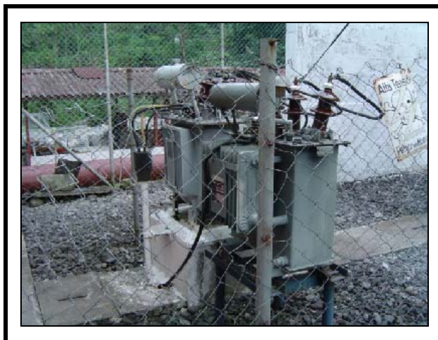
Figura 13 Transformadores de 2.3 KV y 17.5 KVA de servicios auxiliares de la planta hidroeléctrica El Porvenir
