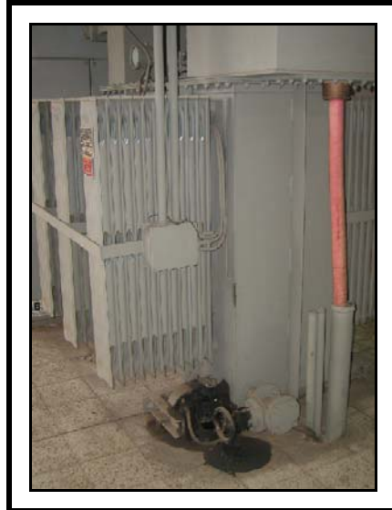
Figura 17 Transformador en la sala 480 V, casa de máquinas
