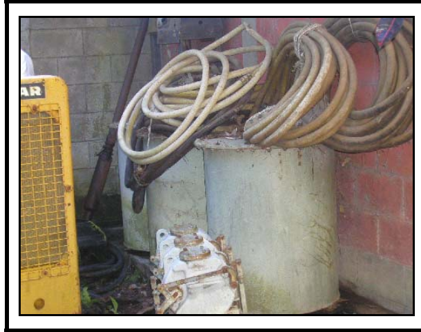
Figura 10 Cilindros que almacenan bobinas contaminados con PCB, cercanos a una vivienda
