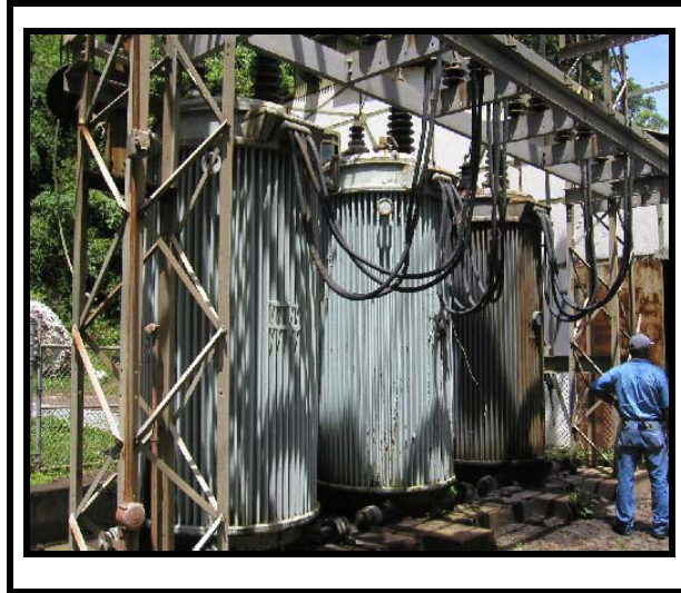
Figura 15 Transformadores de 500 KVA en la subestación Palín I
