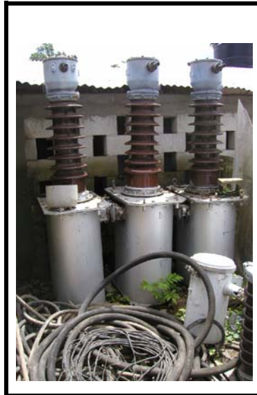
Figura 6 Transformadores de corriente ubicados en el almacén
