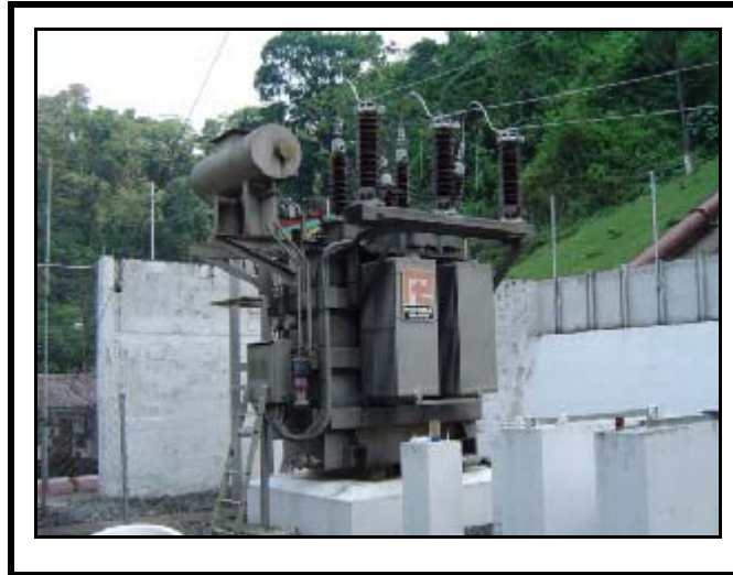
Figura 12 Transformador de 4 MVA, subestación El Porvenir
