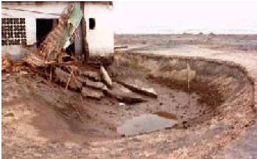
Ilustración 103. Socavamiento de los cimientos (Camaná)
