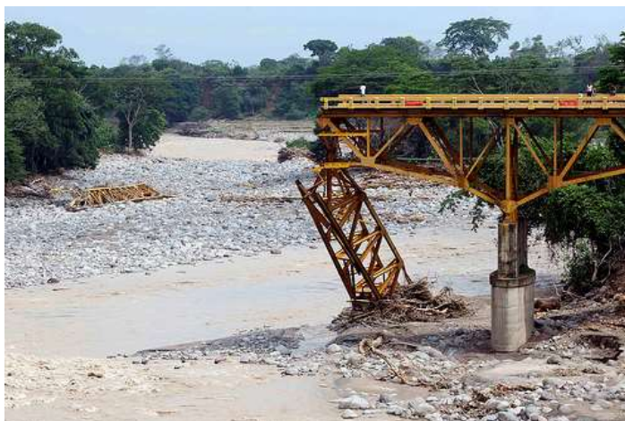
Ilustración 37. Puente colapsado por la Tormenta Tropical Agatha
