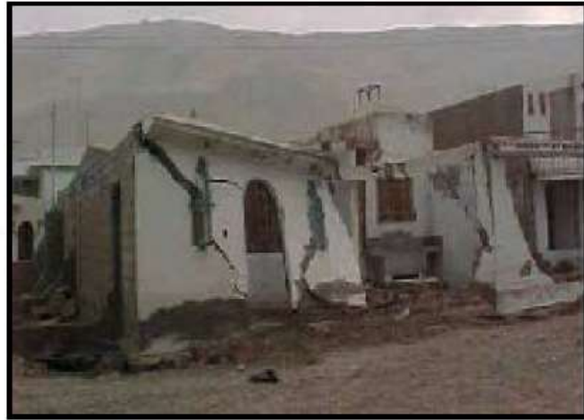
Ilustración 98. Daños Producidos por el momento de flujo en viviendas de bloques de concreto.
