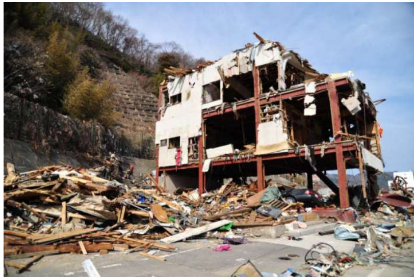
Ilustración 102. Fallo de la mampostería en una estructura de acero en Onagawa, Japón.
