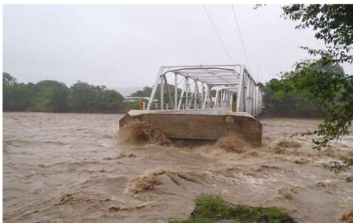
Ilustración 38. - Inhabilitación de paso en puente Manuel José Arce que conecta la Ciudad Pedro de Alvarado, Jutiapa con El Salvador, debido a la crecida del Río Paz.
