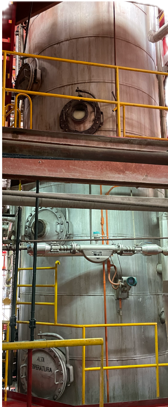
Figura 15: Torre de desodorización de aceite de palma.
