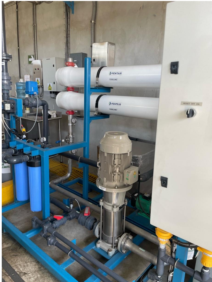
Figura 25: Sistema de osmosis inversa.
