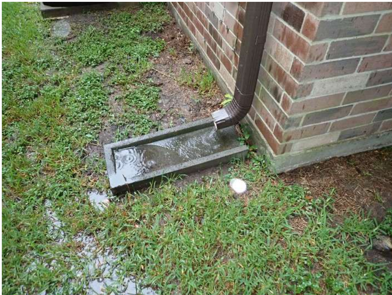
Figura 3: Desconexión de canaleta pluvial
