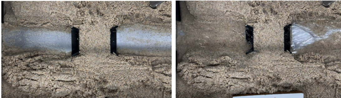
Figura 48. Arrastre de sedimentos, Box Culvert 2 celdas
