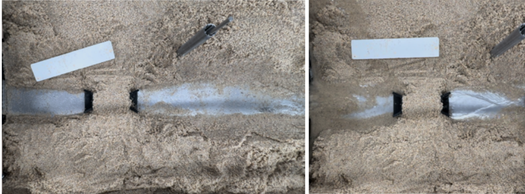
Figura 47. Arrastre de sedimentos, Box Culvert 1 celda
