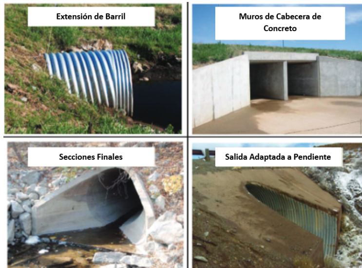
Figura 7. Estructuras de entrada de alcantarillas
