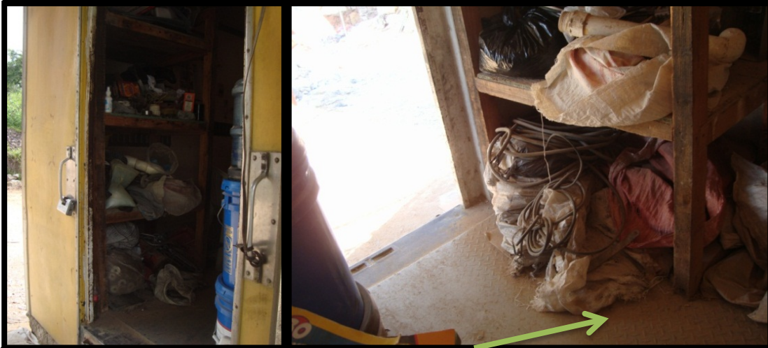
Cables obstruyendo el paso
