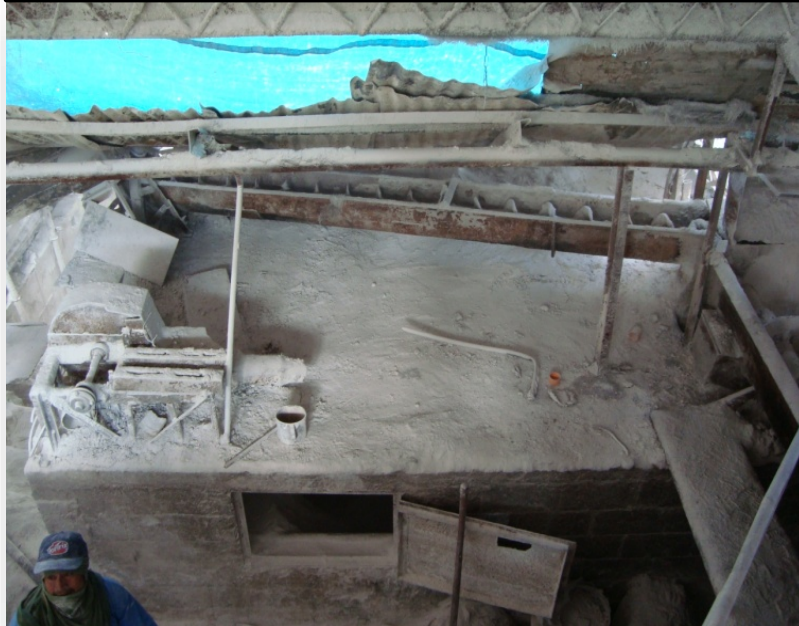
Ilustración 5: Enfriamiento en tanques
